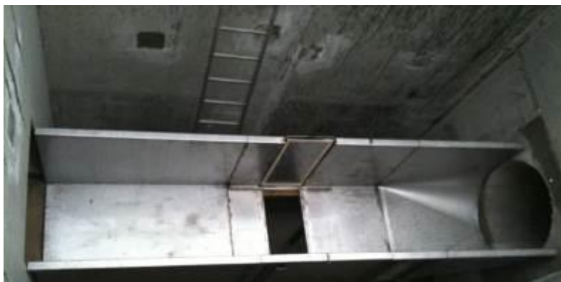
Figure 95 : Photo d'un piège à charriage à Marseille
