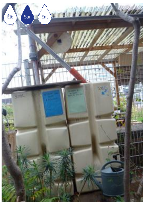
CUVE DE RÉCUPÉRATION DES EAUX PLUVIALES POUR L'ARROSAGE D'UNE TOITURE JARDIN.
