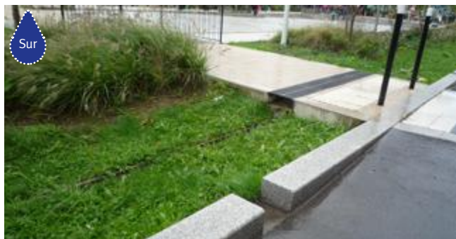
LES 4000 NORD, LA COURNEUVE, NOUE VÉGÉTALISÉE RUISSELLEMENT/HAMELIN. Source : ATM
