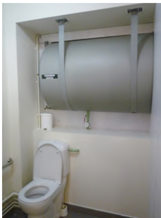
SANITAIRES DE LA MAISON ÉDOUARD GLISSANT AU PARC DÉPARTEMENTAL GEORGES VALBON DE LA COURNEUVE (93), ALIMENTÉS PAR UNE CUVE DE RECYCLAGE DES EAUX PLUVIALES FONCTIONNANT DE FAÇON TOTALEMENT GRAVITAIRE.
