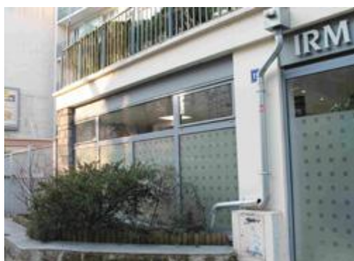
ALIMENTATION D'UNE JARDINIÈRE EN PIED DE FAÇADE PAR RACCORDEMENT DIRECT DE LA GOUTTIÈRE.
